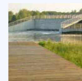
In- en uitwateringssluis
