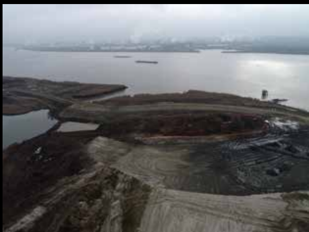
Afb. 15 Detail vooruitgang, november 2019.
